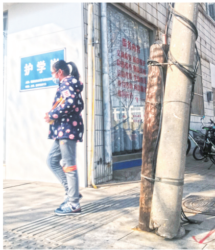
4月13日,一名小学生从根部断裂的线杆前经过
