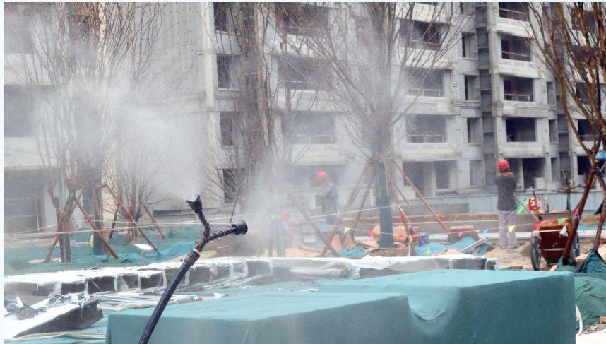
开发区一建筑工地安装的“点式”喷雾设备
