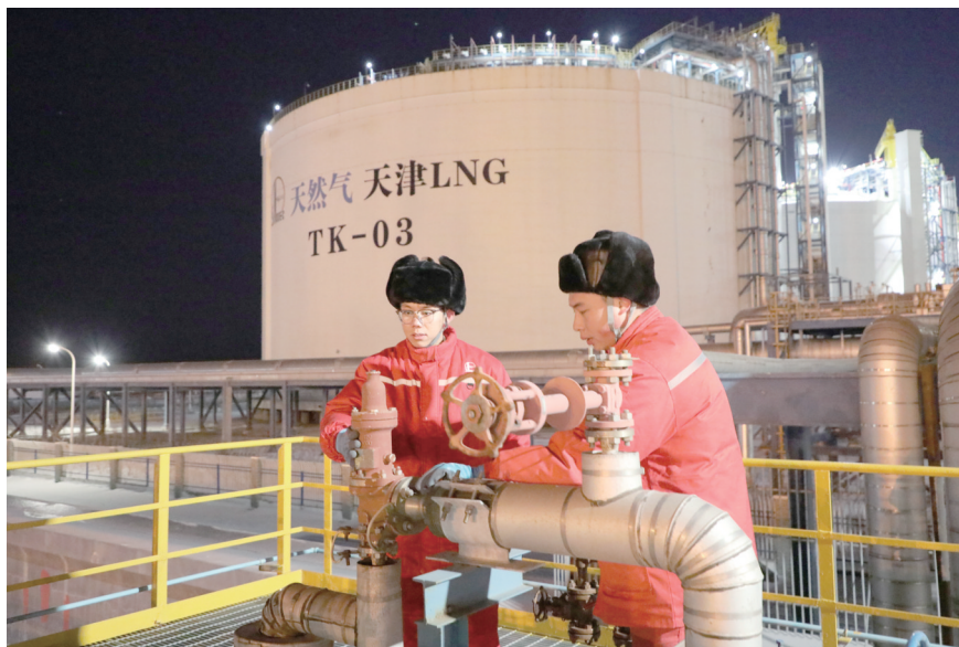
12月16日,工作人员在中国石化天津LNG接收站巡检管道。今年供暖季以来,中国石化天津LNG接收站已接卸12船约70万吨液化天然气(LNG),气化外输天然气7亿立方米,有力保障华北地区人民群众温暖过冬。
