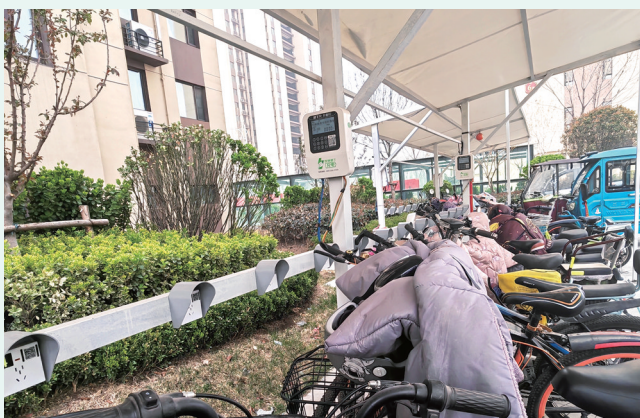
开发区碧桂园·国岳府小区的充电设备
