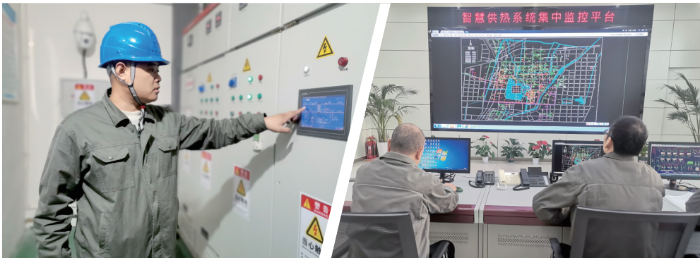
工作人员查看康城花园换热站电控室情况
