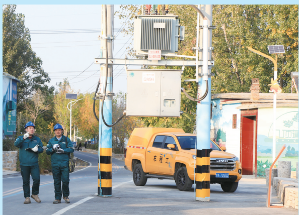
巡检10千伏沿黄线。 本报通讯员 于刘庆 摄
