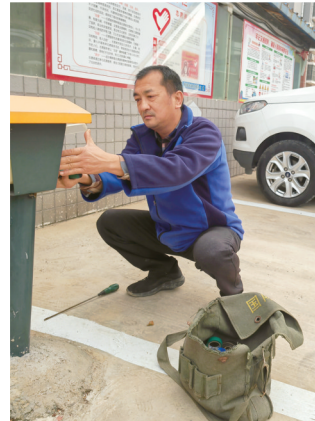
▲电工在维护充电桩
