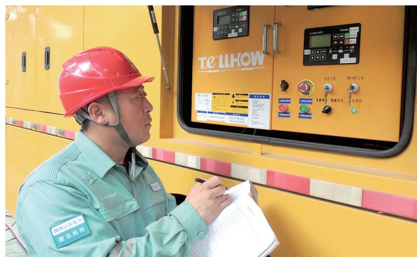
工作人员在检修调试应急电源车。 本报记者 赵迪 摄
