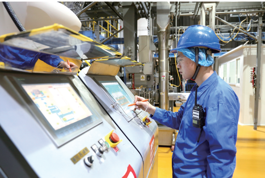
乖宝宠物食品集团技术人员正在调试新引进的生产加工设备
