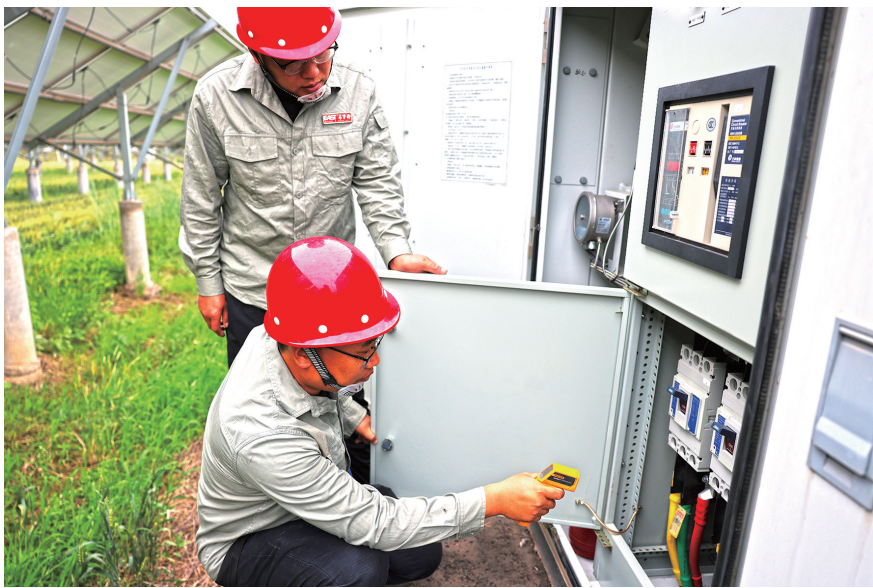
天气炎热,工作人员要随时监测室外供电设施的温度
