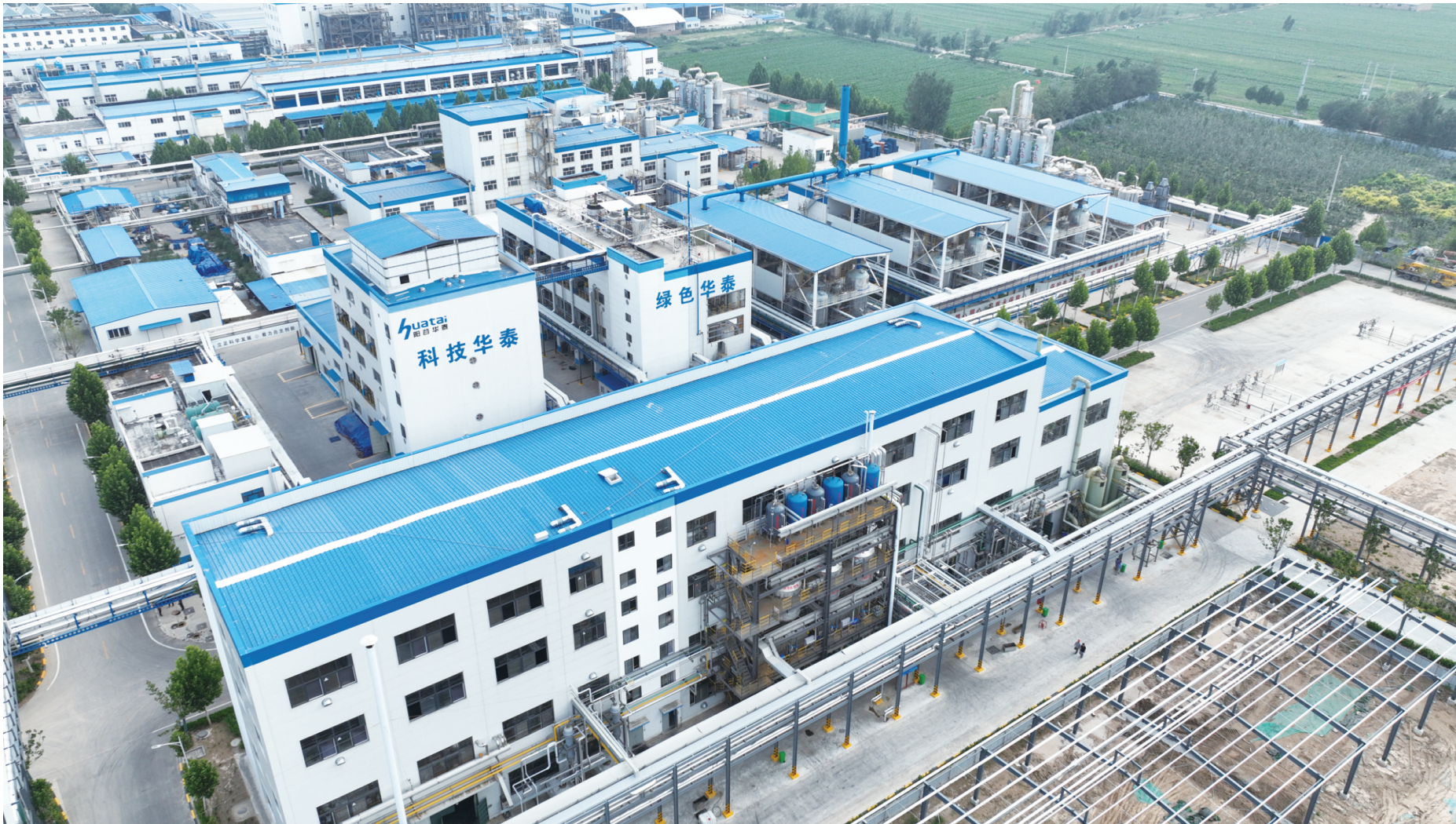
7月15日,在阳谷华泰化工股份有限公司,年产65000吨高性能橡胶助剂项目正在建设中。该项目采用国内先进DCS智控系统,以及全自动生产包装线,生产流程实现智能监管,关键点位实现一键运行、无人操作,生产效率提高60%。
