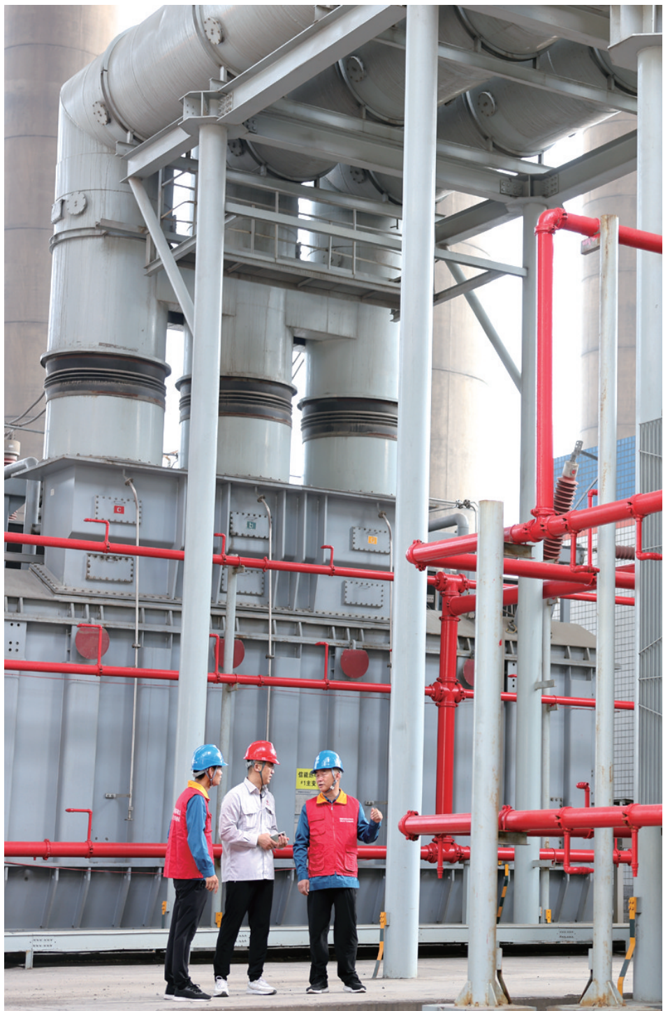
查看企业电力设备运行情况
