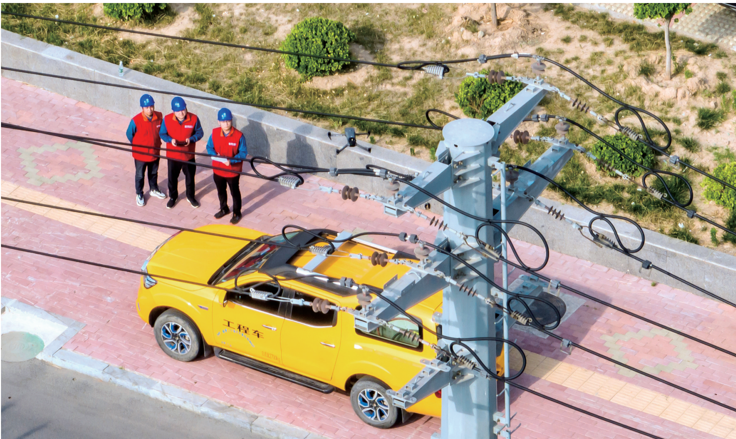
运用无人机对10千伏松桂线进行特巡
