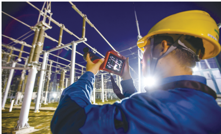
在220千伏端庄站对设备进行夜间测温
