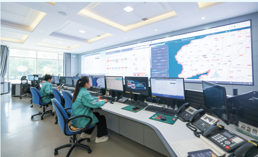
供电服务指挥中心的配网全景监测平台
