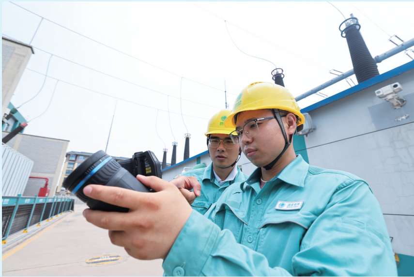
对变电站内的主变等设备进行红外测温
