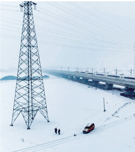
12月12日,国网聊城供电公司工作人员雪中巡检为济郑高铁牵引站供电的220千伏铁线。
