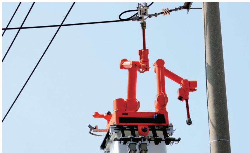
机器人加装故障指示器
