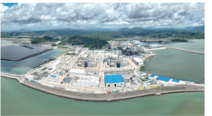
在福建省云霄县拍摄的建设中的漳州核电站(7月7日摄,无人机全景照片)。近年来,福建省依托本地清洁能源禀赋与区位优势,全力打造智慧化、主配微协同的新型电网和我国东南清洁能源大枢纽,提速电力外送通道建设,稳步升级城乡配电网、推广智能微网建设,持续盘活清洁能源优势,以智慧新型电网建设支撑能源保障根基,全方位赋能经济社会高质量发展。新华社记者 林善传 摄
